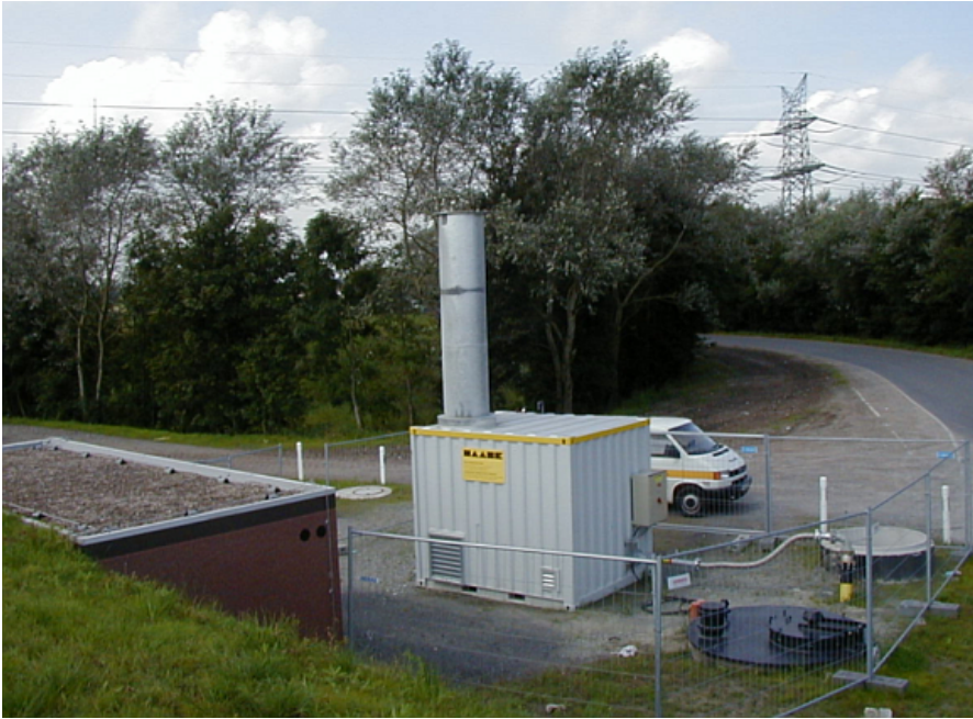
Abbildung 4: Deponiegasverdichter- und Fackelanlage (750 kW th )
