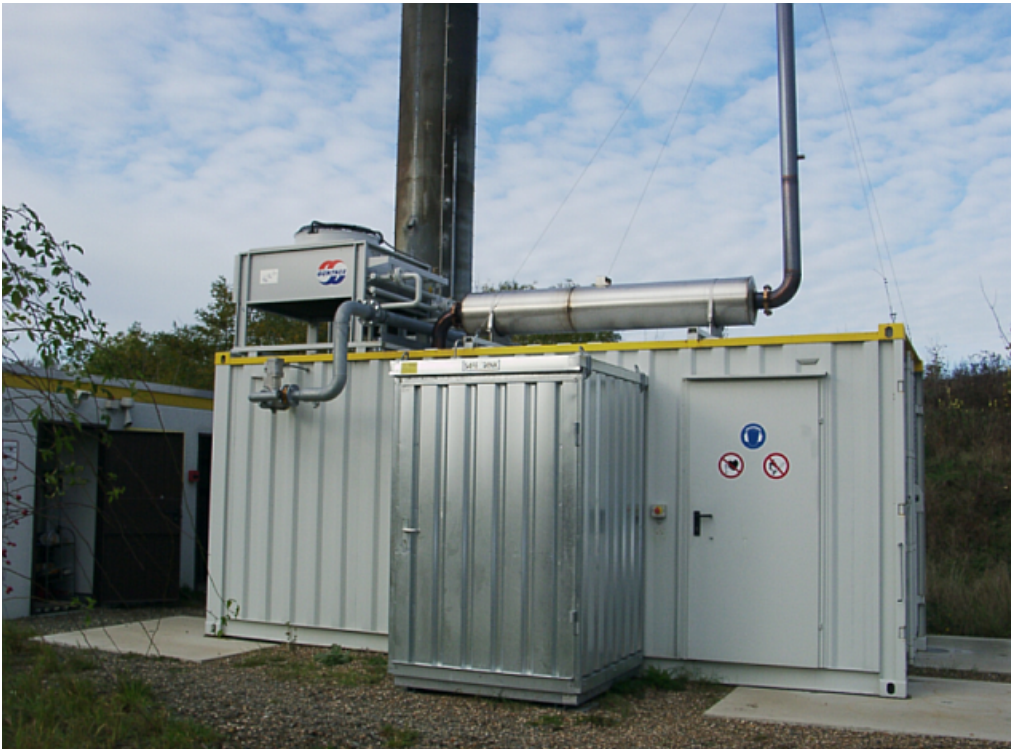
Abbildung 3: Deponiegas-BHKW mit Gasverdichter (Kompaktanlage 143 kWel)
